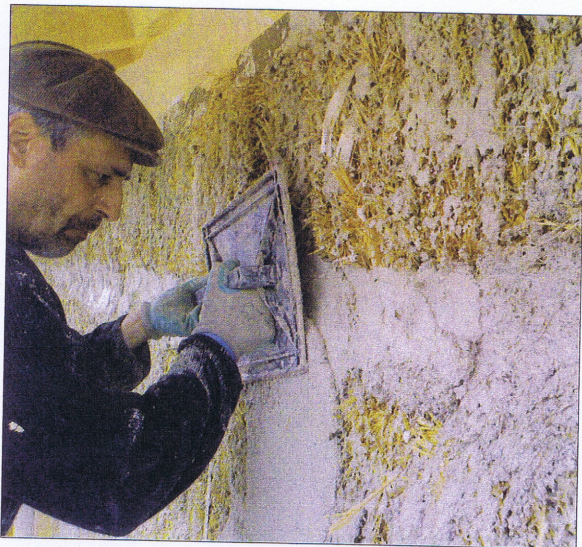
Avant d'appliquer l'enduit de chaux, les joints entre les différents matériaux sont colmatés.
